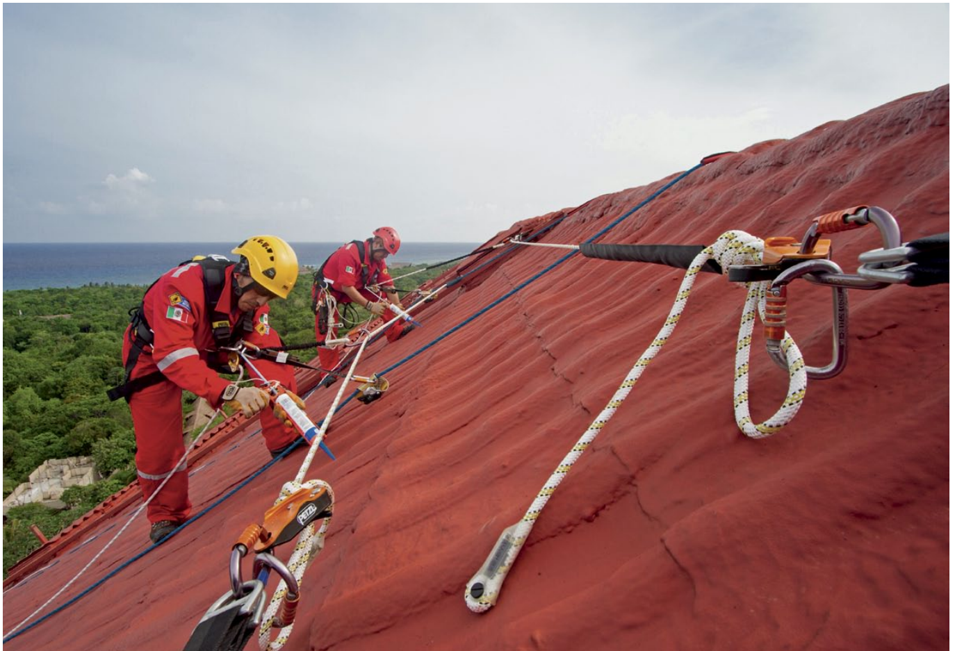
Trabajos en Alturas, Xcaret Park, Riviera Maya, Playa del Carmen, Mexico © Marcos Ferró
