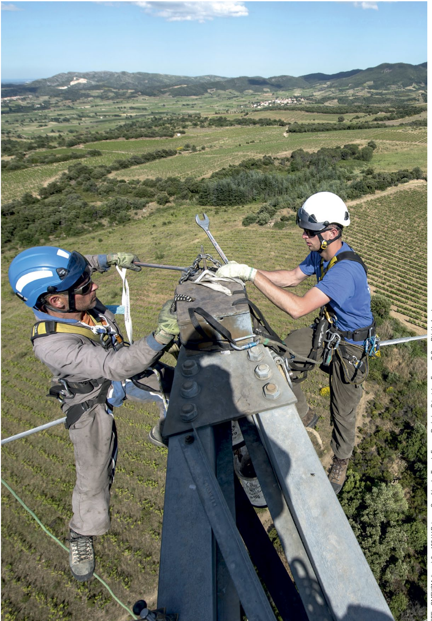
EEE - OMEXOM, ligne à 2 x 400 kV Baixas - Gaudière, La Tour de France, Pyrénées Orientales, France © Sam Blé / Latouche
