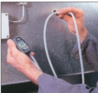
Luftströmungsmessung mit dem Staurohr
